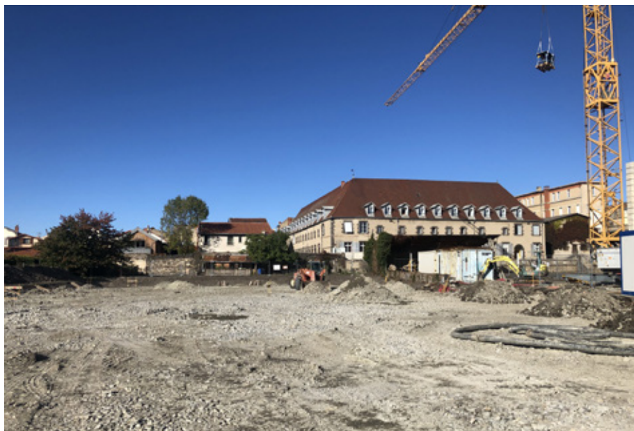
En quelques jours les jardins ont disparu, laissant la place à la plateforme qui accueillera le gymnase
